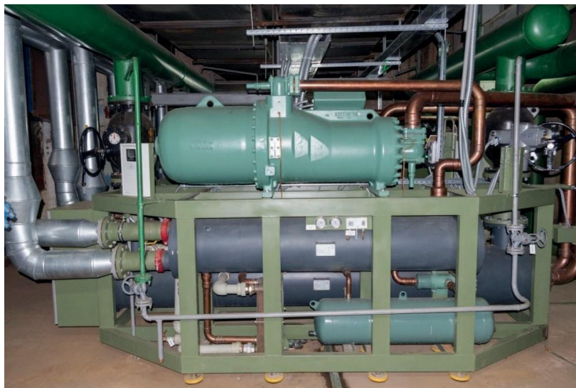
Теплонасосний блок ЕКОМ-1500 вітчизняного виробництва потужністю 1500 кВт
